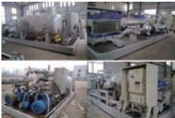
图 1 大凤储罐机械清洗系统设备实物
