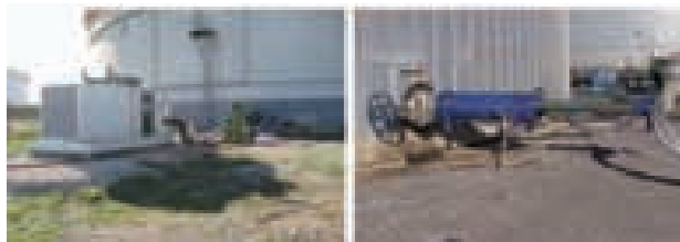
图 9 COS 第一阶段现场使用实景
