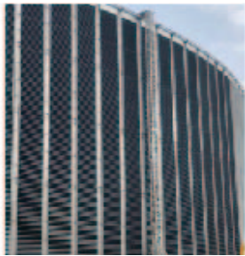
图 2 间接空冷清洗系统
