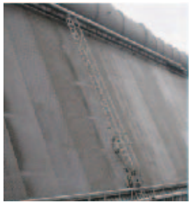
图 1 直接空冷清洗系统
